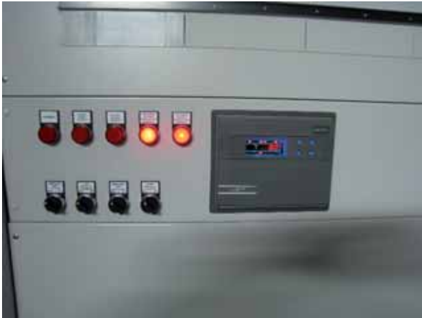
Un controlador local.
