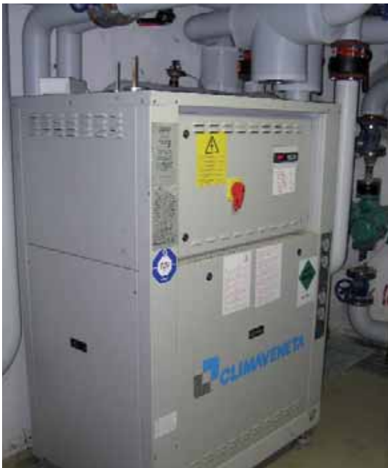
Bomba de calor para la iglesia.
