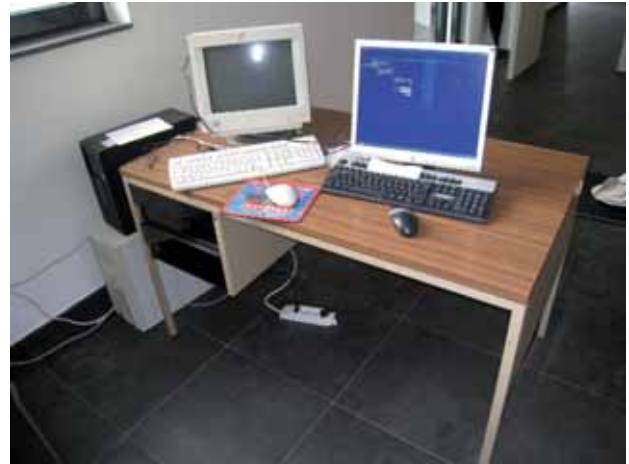
La unidad de control BMS.
