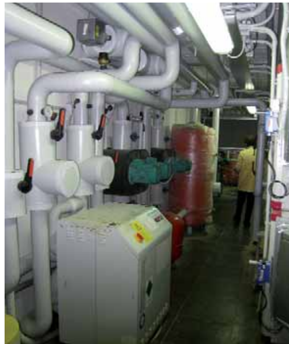
Bomba de calor para la Sala Parroquial.
